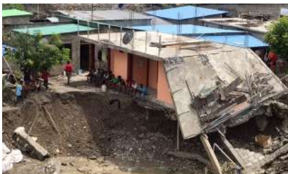
Derrocada de uma residência familiar nas margens do rio Comoro em Dili
