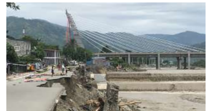
Abatimento da estrada marginal do rio Comoro, por falência das infra-estruturas de contenção e muros de proteção.
